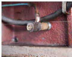
給電ブロック
